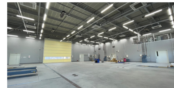
▲全館空調を導入した整備工場
