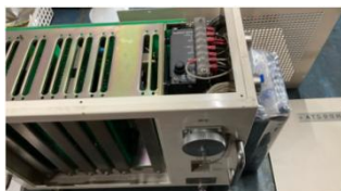
▲ATS受信器内蔵電源取替
